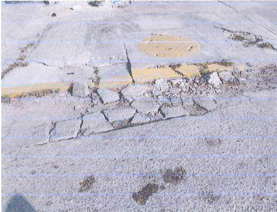
Imagen 1. Daños y deterioro en banquetas y guarniciones.
