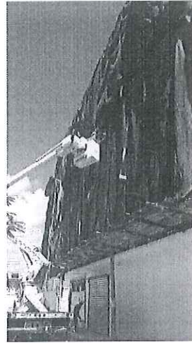
11.1 nivelación de luminaria volteada por efectos del huracán Grace.
